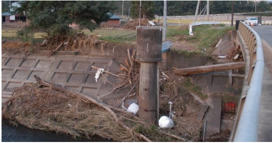
撮影場所：岩手県盛岡市好摩字小袋地先 古川橋（松川）水位観測所 平成 25 年台風 18 号による増水(9 月 16 日)で水没した古川橋水位観測所 撮影 平成 25 年 9 月 29 日
